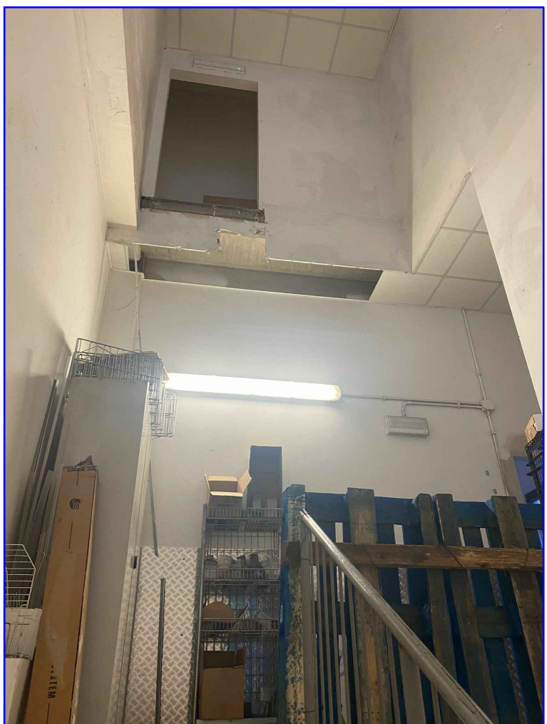
FOTO 6 Vista sull'area destinata all'inserimento di nuova scala in struttura leggera di accesso ai nuovi Uffici di Piano primo
